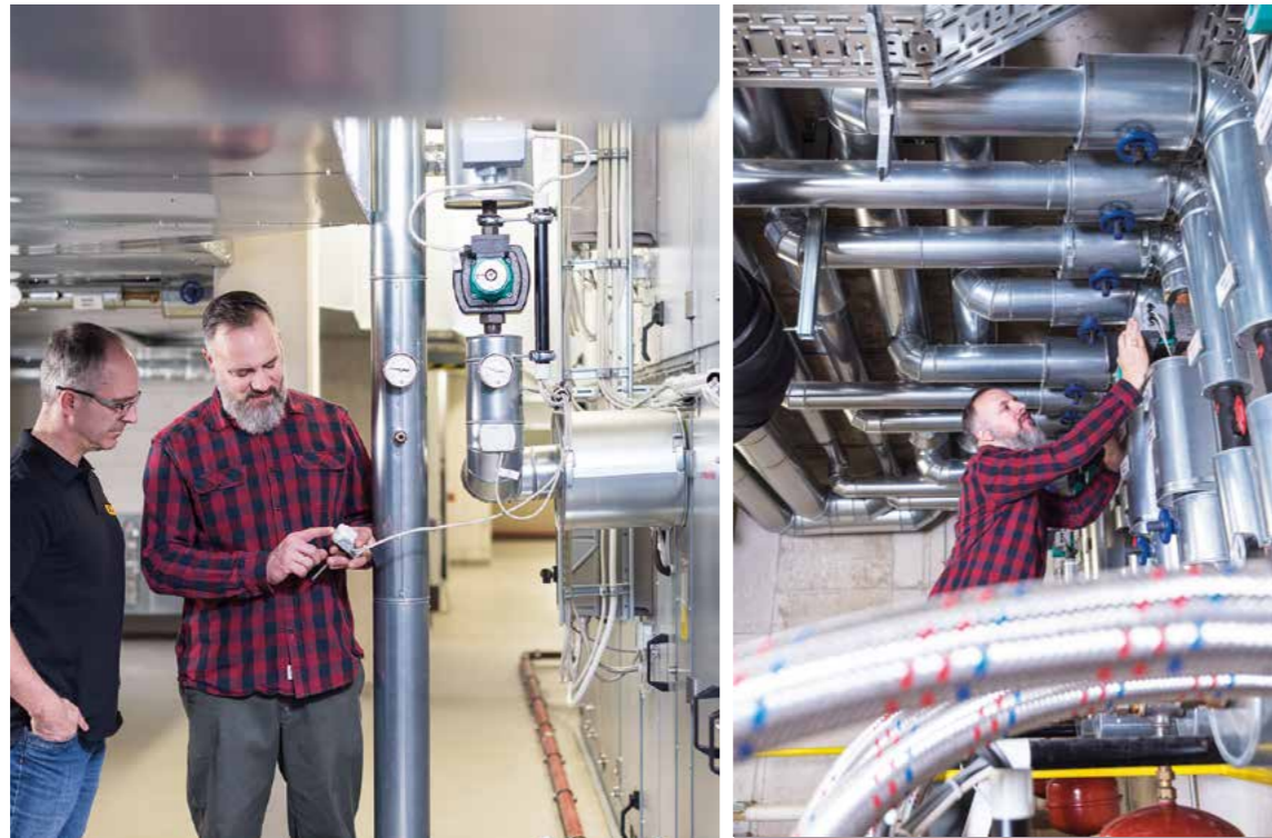
Kontrolle und Optimierung Anlagentechnik
